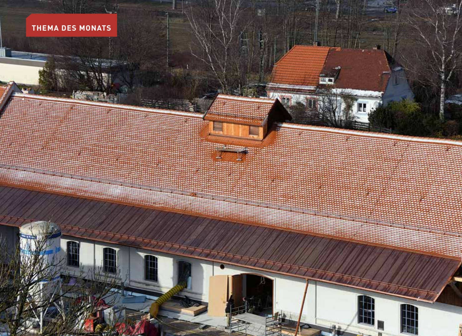
▲ Das frisch gedeckte Dach des ehemaligen Ochsenstalls mit seinen Rundschnittbibern und dem charakteristischen Vordach mit neuer Kupferblechdeckung
