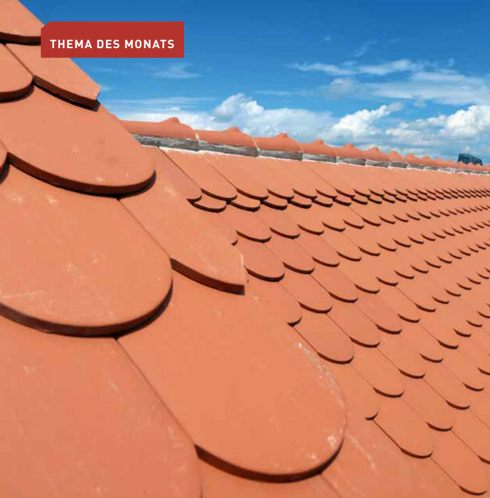
▲ Die neuen Biber haben eine gebürstete Oberfläche und werden – wie gewünscht – bald vermoosen
